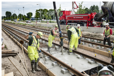
Figuur 1 Ze zijn nu al ruim een maand bezig overal beton aan het storten. 1
